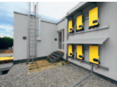
Messanlagen im Pilotnetz.
