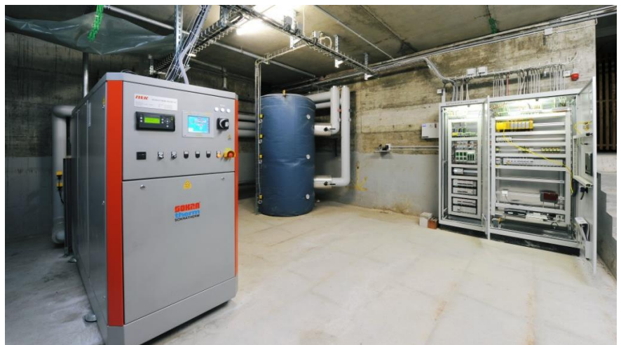
BHKW mit Brauchwarmwasserspeicher und Steuerschrank im Alters- und Pflegeheim
