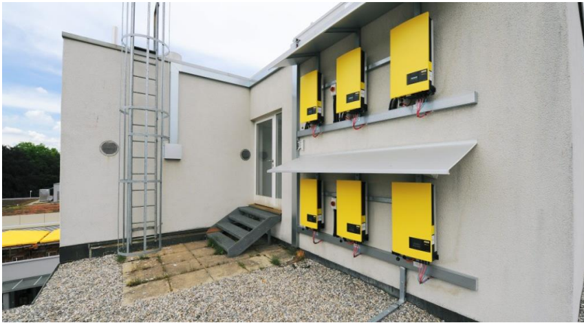
Wechselrichterplatzierung der PV-Anlage auf dem Dach des Alters- und Pflegeheims
