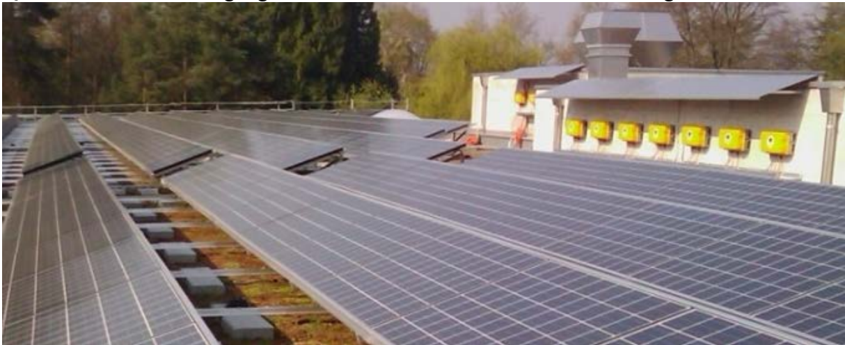
PV-Anlage Parkhaus Kurzentrum mit den Wechselrichtern (gelbe Boxen)
