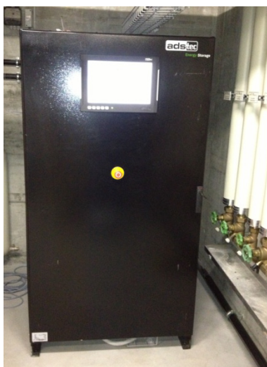
Die Wechselrichtereinheit der Batterieanlage bei der Wohnbaugenossenschaft Zähringer
