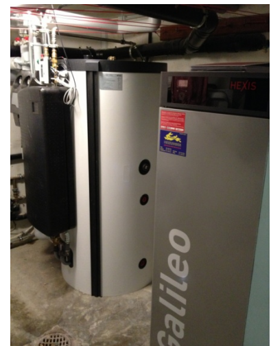
Die erste Brennstoffzellen-Anlage im VEiN-Netz
