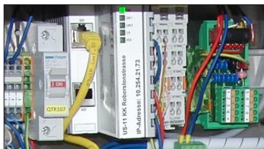
Leitsystem Unterstation KK Roberstenstrasse
