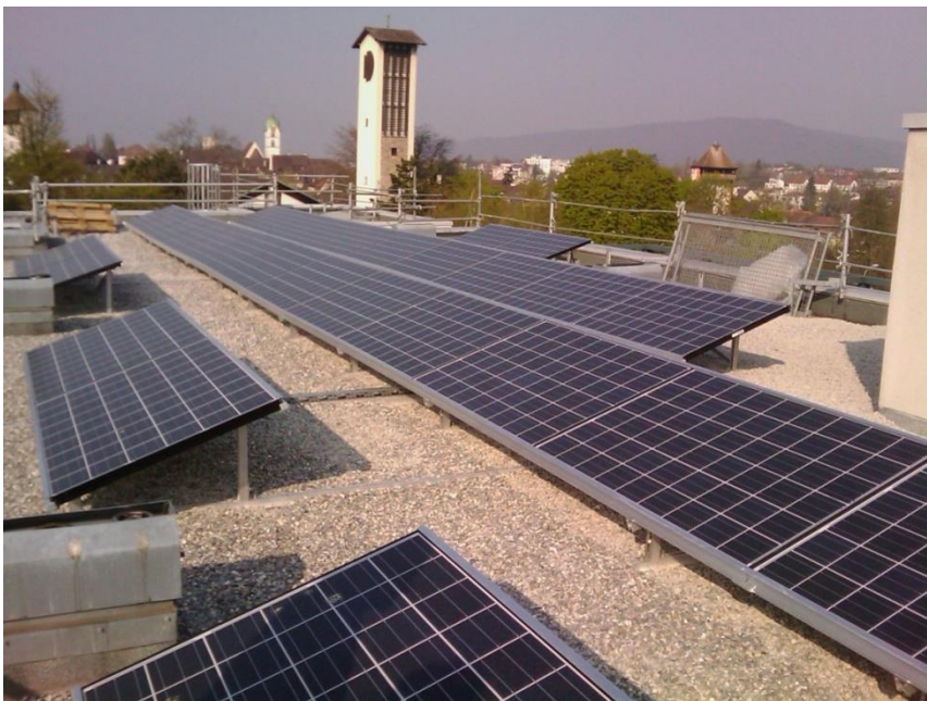
Abbildung 5: Photovoltaik-Anlage Alters- und Pflegeheim Rheinfelden, 31 KWp, Inbetriebnahme Mai 2010
