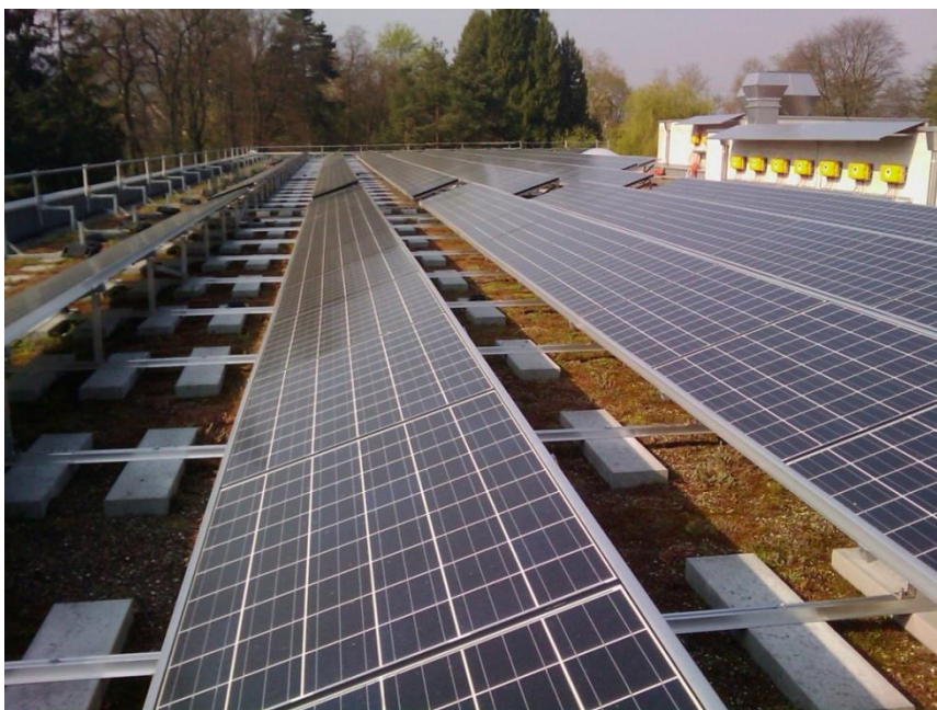
Abbildung 6: Photovoltaik-Anlage Parkhaus Kurzentrum, 60 KWp, Inbetriebnahme Mai 2010
