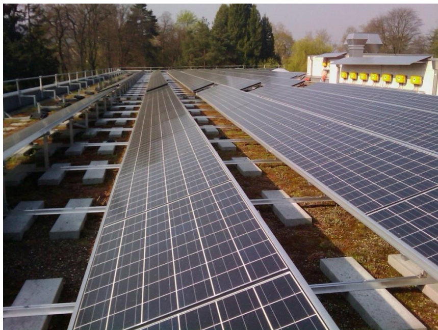
Abbildung 6: Photovoltaik-Anlage Parkhaus Kurzentrum, 60 KWp, Inbetriebnahme Mai 2010
